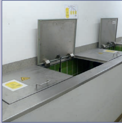
Schächte für radioaktiven Abfall unterschiedlicher HWZ im Abklingraum.
